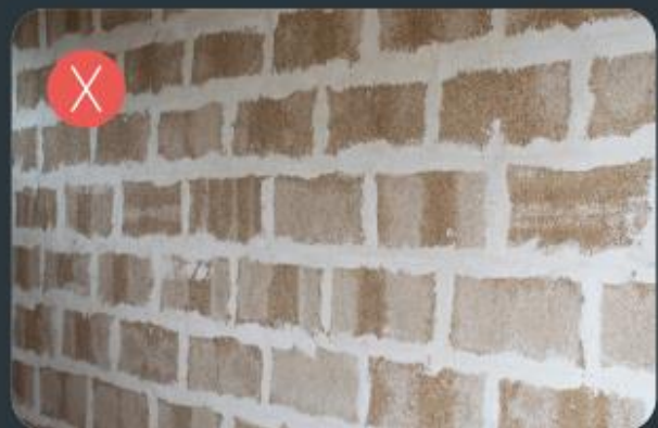
Mauvais traitement des joints
